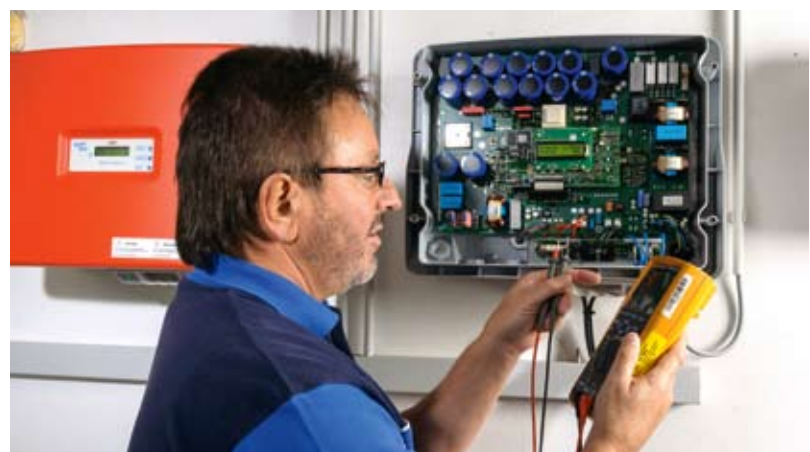
Die Wechselrichter sind das Herzstück einer PV-Anlage. Eine Option ist es, die Technik gegen innere Betriebsschäden zu versichern.
