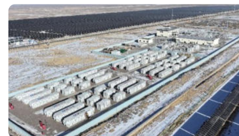
Gansu, China 60MW / 120MWh
