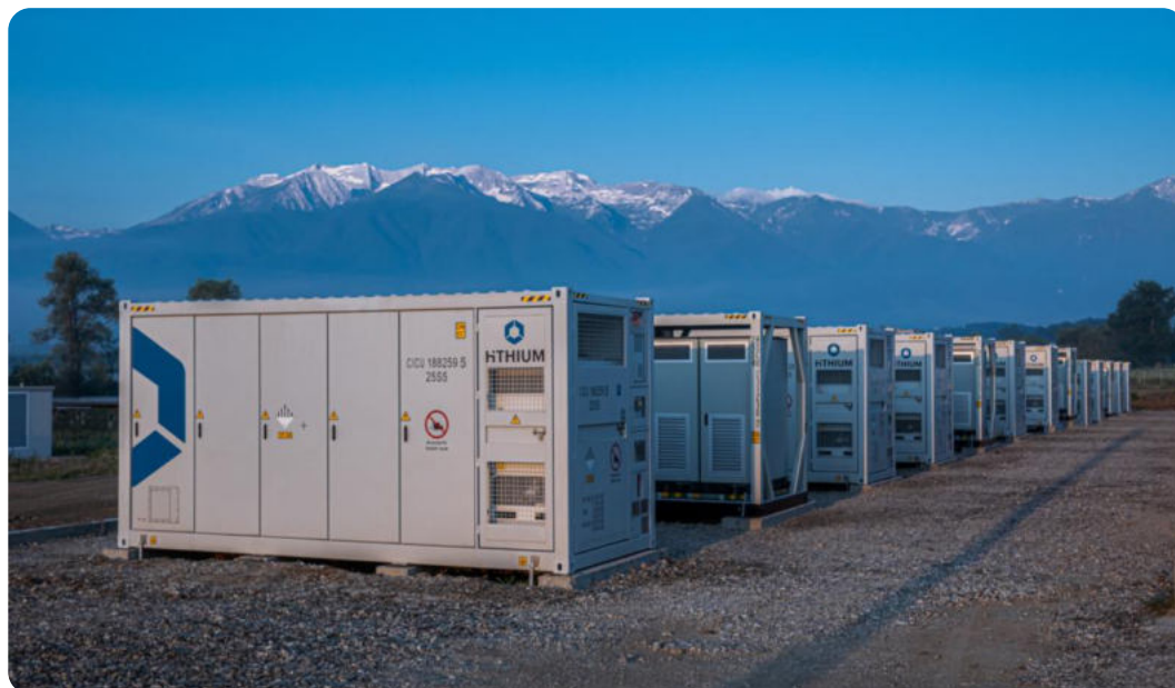
Razlo, Bulgaria 25MW / 55MWh
