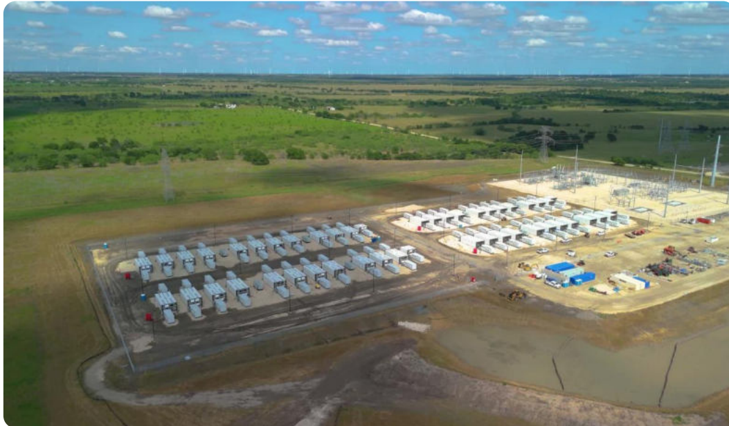
Texas, USA 300MW / 600MWh
